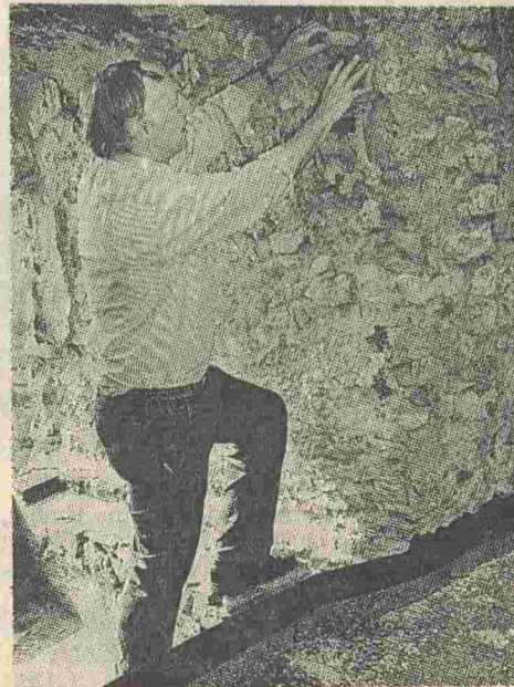
Burgbesitzer Heinz Lauer hofft, daß das Bröck- keln der alten Mauern aufgehalten werden kann. Bild: Schwetasch
